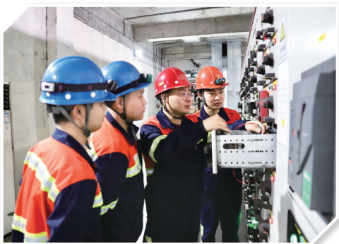
葛彩迁在检查配电柜(右二)
