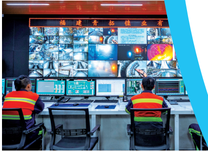
青拓镍业有限公司中控室
