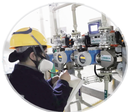
青美10万吨磷酸铁锂动力电池的生产车间
